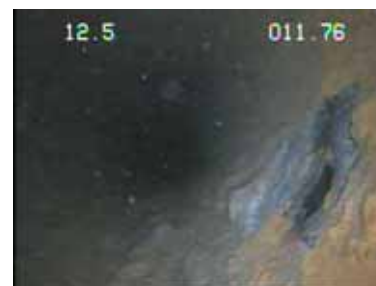
破損部を上から見たところ
